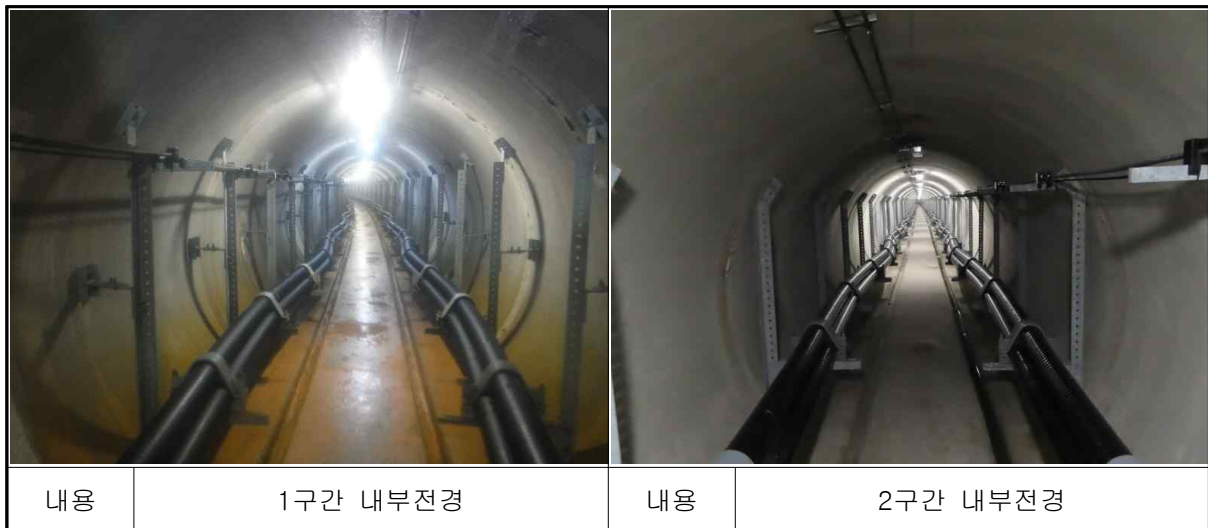
[사진 5.1] 문산-선유 전력구 현황
